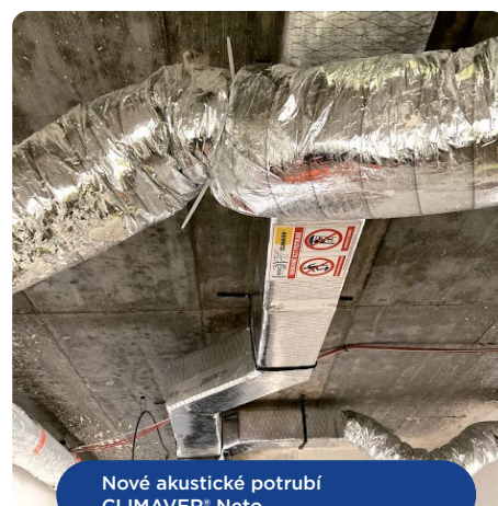
Původní trasa – plechové potrubí s tlumičem hluku
