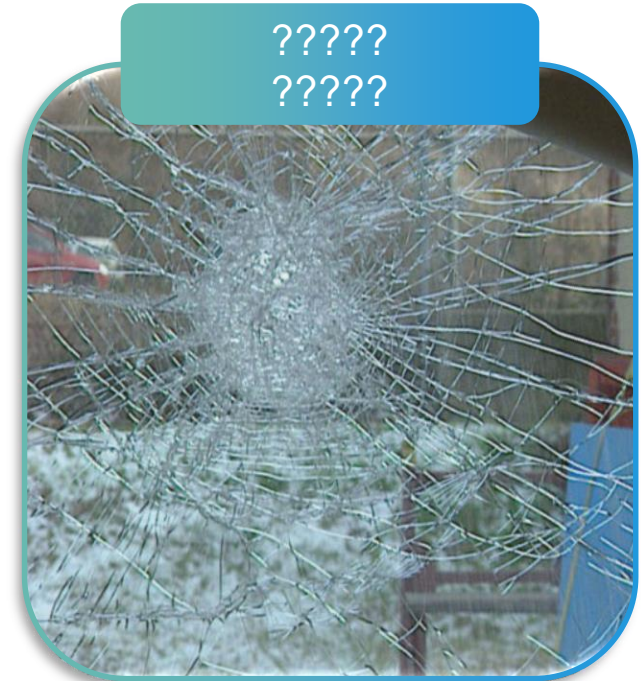
Při rozbití drží vcelku jen je popraskané.
