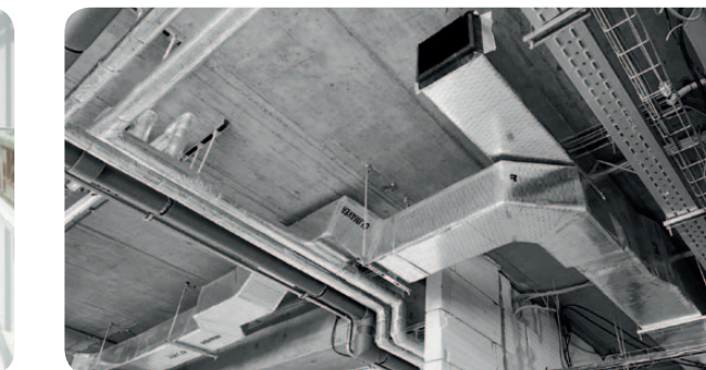
Největší realizace v ČR. Vyrobeno a nainstalováno přes 6000 m² potrubí.
