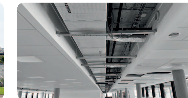
Páteřní rozvod ve všech podlažích kancelářských prostor.
