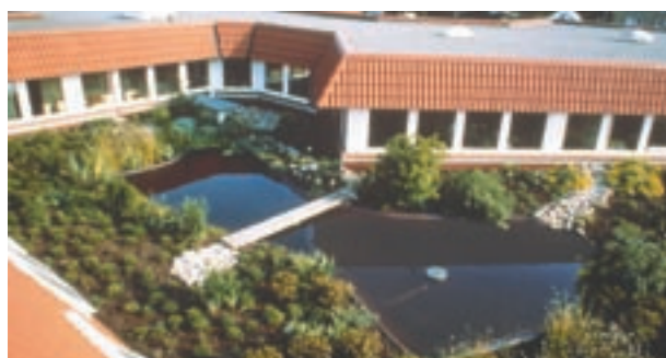
Obr. 6: Ozeleněná a pochůzná střešní terasa s fóliovými jezírky nad obrácenou střešní konstrukcí s celoplošnou štěrkovou drenážní vrstvou.
