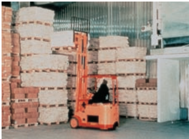
Obr. 14: Vysokozdvíhací vozík a skladované zboží zatěžují tepelně izolovanou podlahu chladírny.
