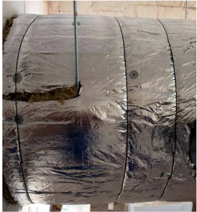
Obr. 13 Narušení lamelové rohože drážkou nutnou kvůli nasouvání izolace přes závěsnou tyč
