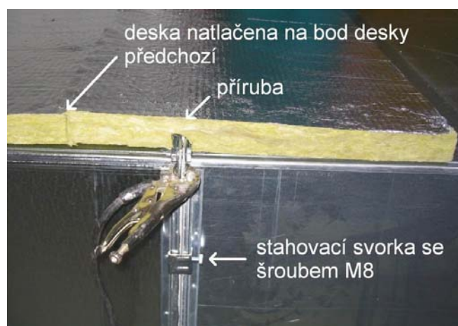
Obr. 12 Spoje izolačních desek leží mimo přírubu VZT potrubí
